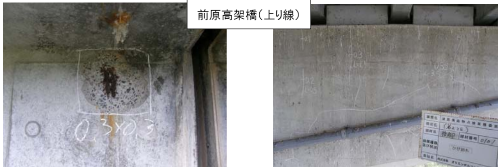
橋梁【コンクリート剥離・鉄筋露出】
