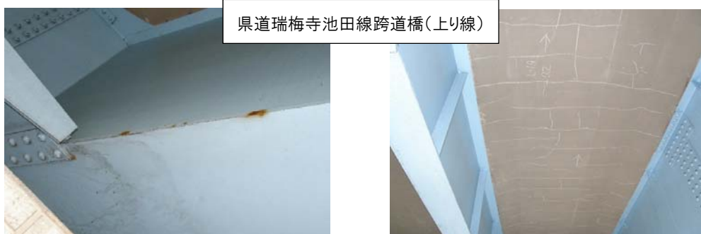
橋梁【主桁の腐食】
